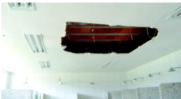
Reforma do vestiário do banheiro society, visto que a obra entregue pela gestão anterior começou a se deteriorar após três meses de uso. Na ocasião, o teto de gesso cedeu, houve vazamento de água e entupimento nos canos. Portanto, foi feito um teto de PVC com alumínio e reconstituído todo o sistema de água e esgoto.
